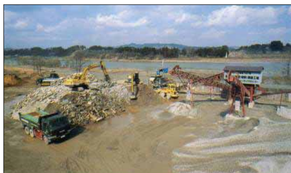
小千谷コンクリートリサイクルセンタープラント全景
