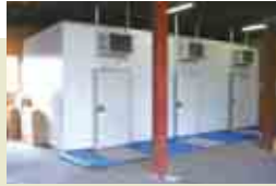
リンゴ農家の冷蔵貯蔵技術を転用した熟成酒の製造現場
