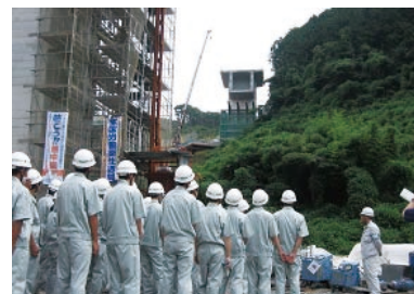
西九州自動車道の建設工事現場を見学 (長崎県3校の合同)
