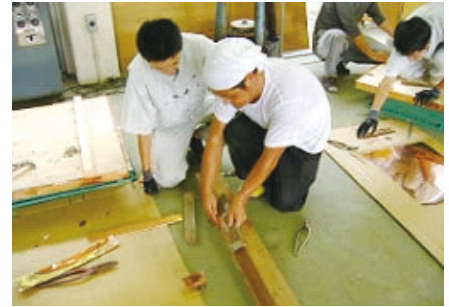
瓦棒ぶきの作成、折り曲げ加工の指導を受ける (栃木県立今市工業高等学校)
