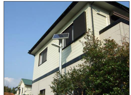
試験的に設置されたソーラー街路灯。驚きの照度を確保できる
