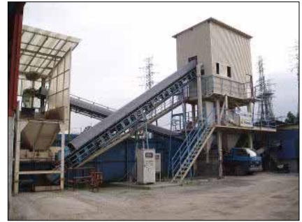
ガラス再資源化プラント((株)中建産業所有)。回収した廃ガラス瓶を破碎し、ガラスカレットに加工。ガラスカレットをアスファルトに配合して有効利用を図る
